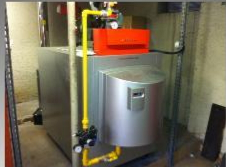
REPLACEMENT CHAUDIERES PISCINE-BRUEGHEL- GROUPES SCOLAIRES PONT- ARBRE VERT : 103 000 €
